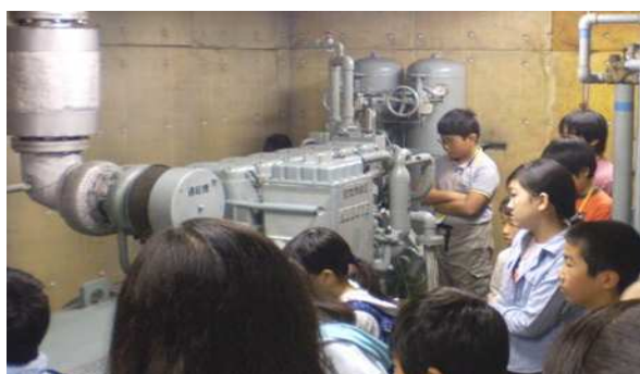
非常用電源室です。一定時間の電気が供給できませんが、幸い使ったことはないとのことでした。
