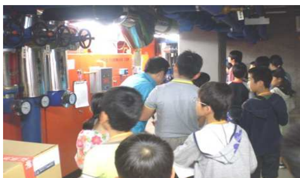
ポンプ室です。普段は公開されていない場所です。全館の水と空調を管理しています。
