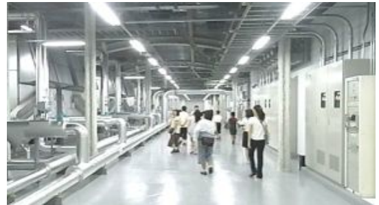
施設見学もさせていただきました。ここは「地球シミュレータ」の空調機室です。
